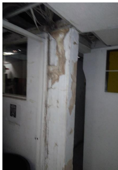
Fotografía 2. Mal estado interior de la estructura del área de laboratorio clínico.
